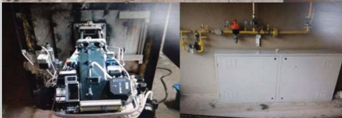
Κατασκευάστηκε δίκτυο φυσικού αερίου στις εγκαταστάσεις του Στρατοπέδου «ΠΑΠΑΓΟΥ» για τη λειτουργία των κεντρικών θερμάνσεων, στο κυρίως κτήριο των Γενικών Επιτελείων.
