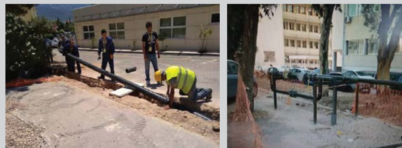
Κατασκευή δικτύου φυσικού αερίου στις εγκαταστάσεις του Στρώου «ΠΑΠΑΓΟΥ», για τη λειτουργία των κεντρικών θερμάνσεων στο κυρίως κτήριο των Γενικών Επιτελείων.
