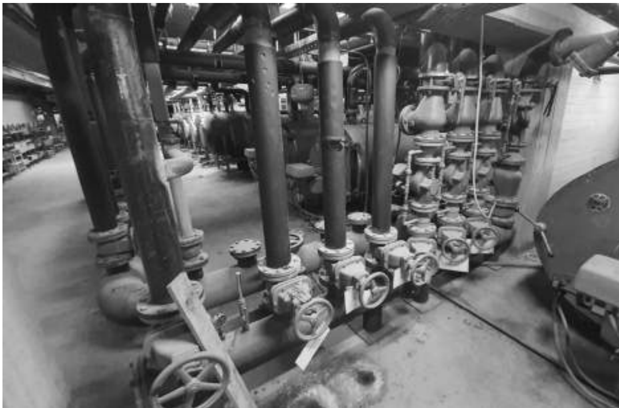
Εικόνα 2.4.2: Κεντρικός Διανομέας - Συλλέκτης Θερμού Νερού
