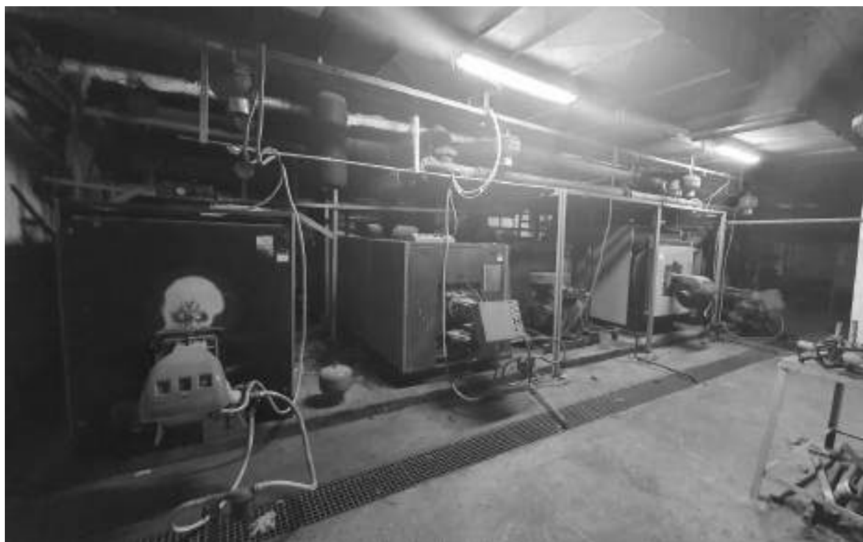
Πίνακας 2.4.13: Καταγραφή Λεβήτων Θερμού Νερού
