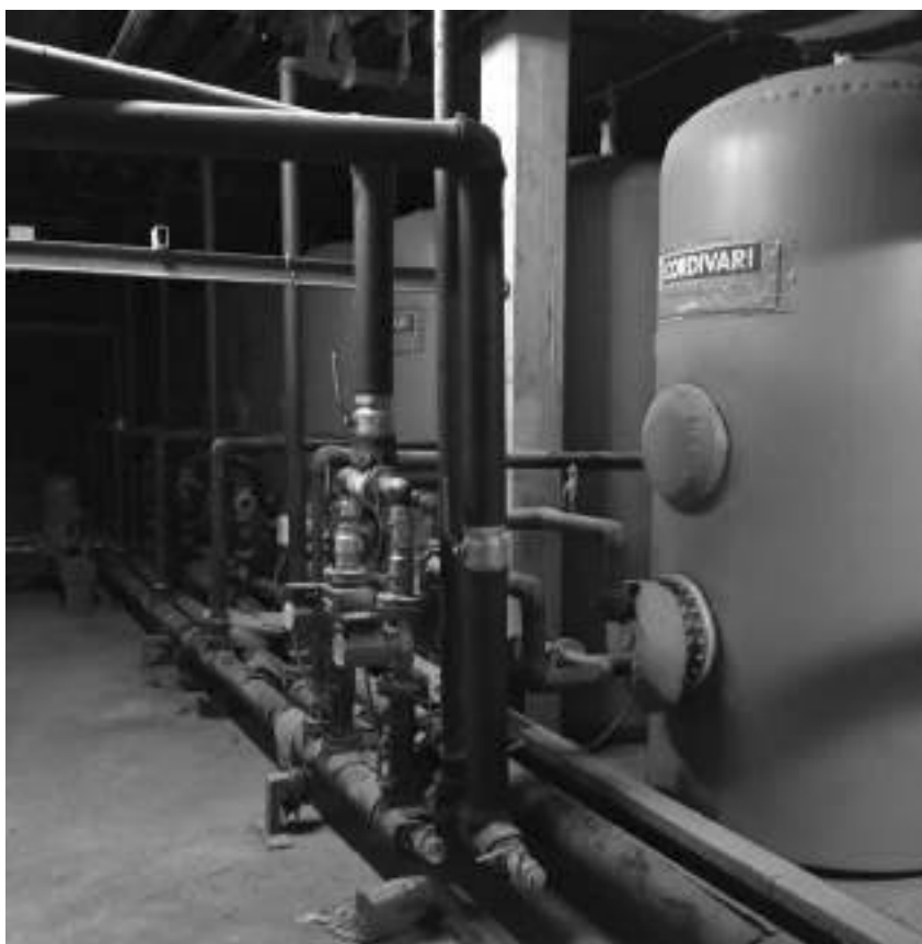
Εικόνα 2.4.16: Θερμαντήρες (Boiler) του κτιρίου
