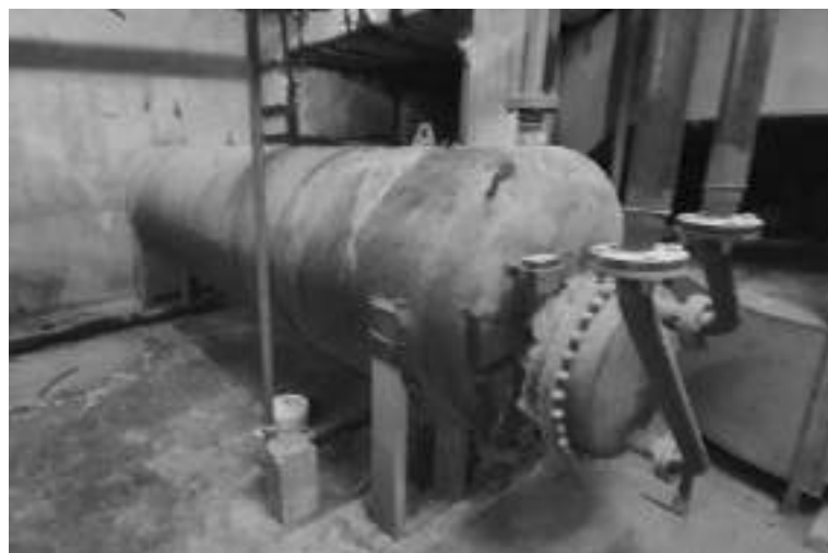
Εικόνες 2.4.19: Θερμαντήρας (Boiler) του κτιρίου
