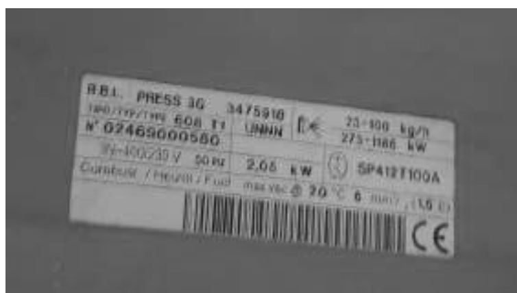
Εικόνες 2.4.1: Λέβητες Θερμού Νερού κτιρίου
