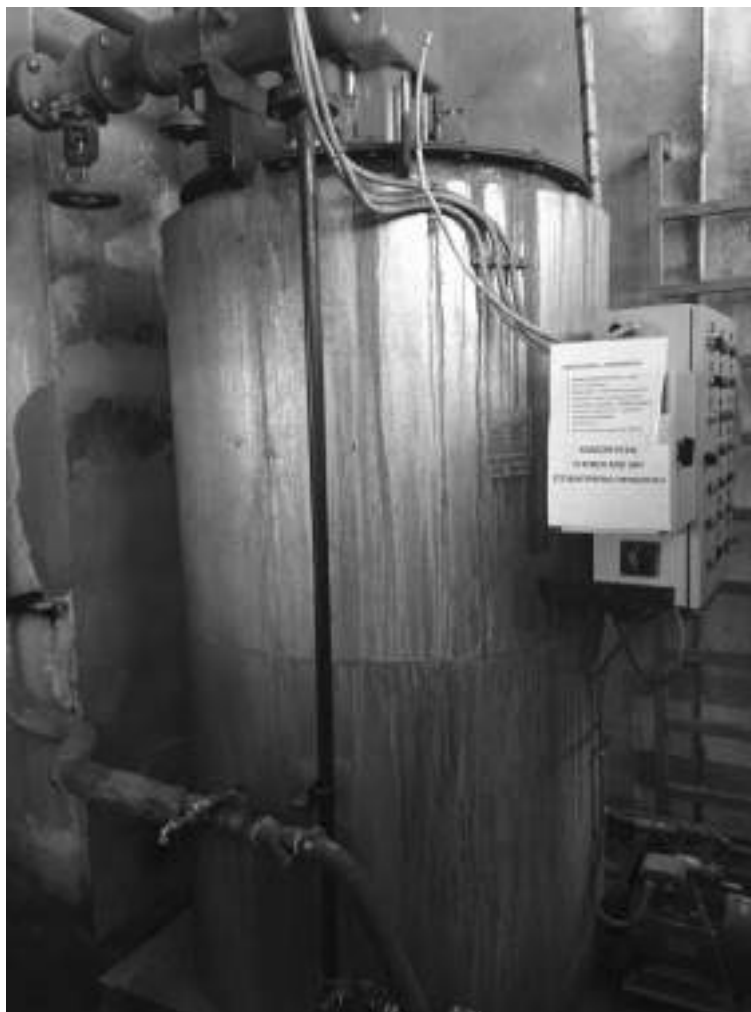
Εικόνα 2.4.21: Ατμογεννήτρια για την εξυπηρέτηση των πλυντηρίων
