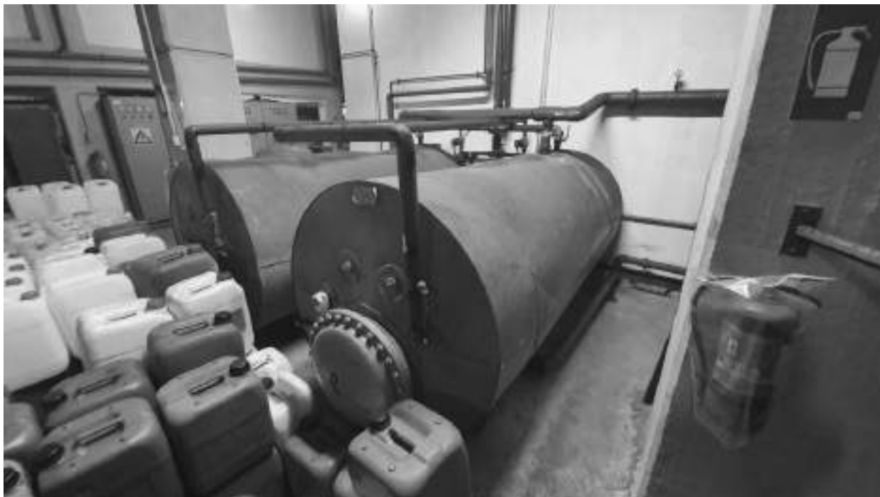
Εικόνα 2.4.8: Θερμαντήρες (Boiler) του κτιρίου
