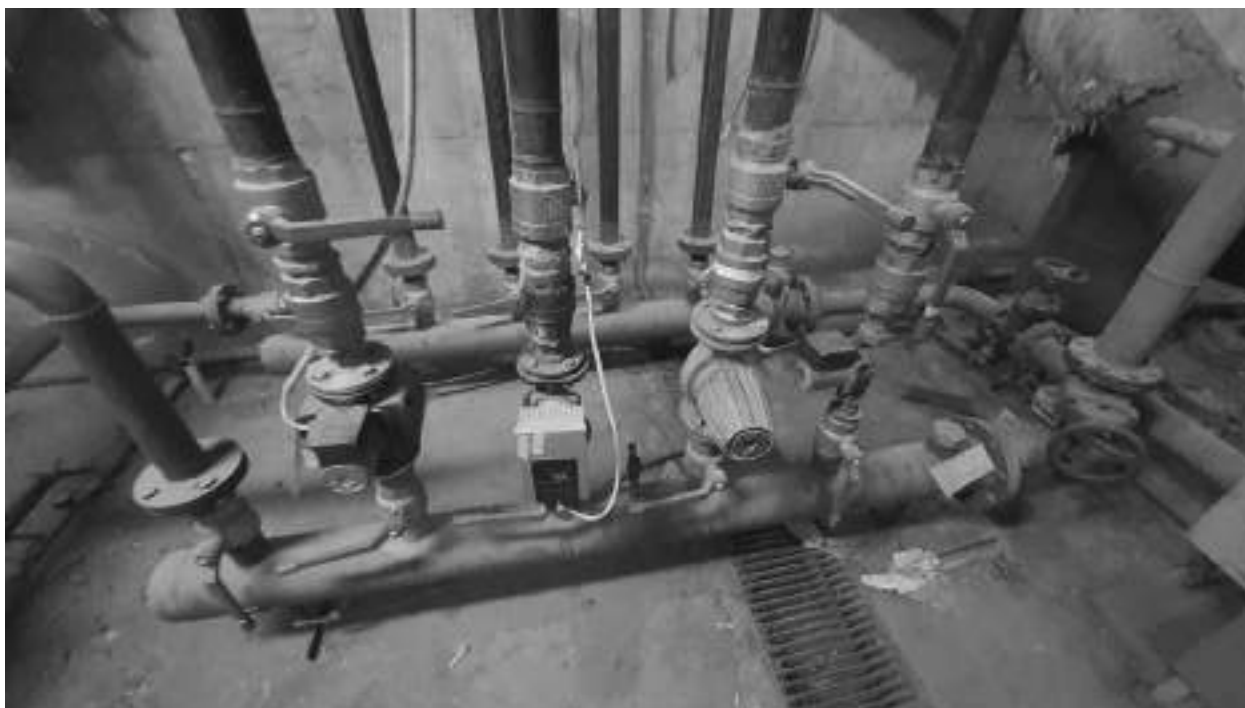
Εικόνα 2.4.18: Κεντρικός Διανομέας - Συλλέκτης Θερμού Νερού
