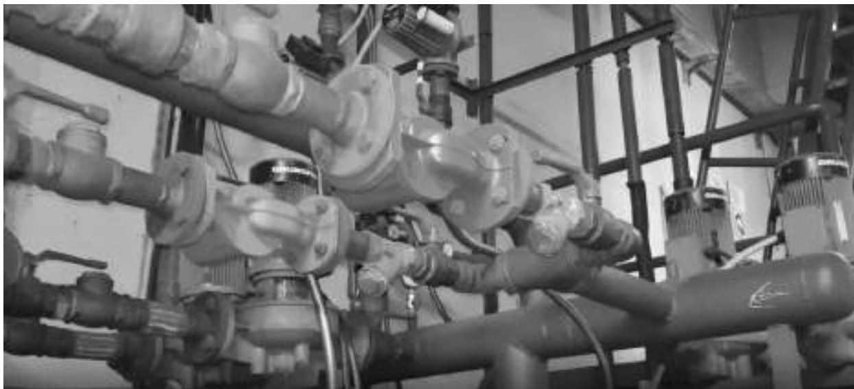
Εικόνα 2.4.7: Διανομέας – Συλλέκτης Θέρμανσης Χώρου & Πισίνας
