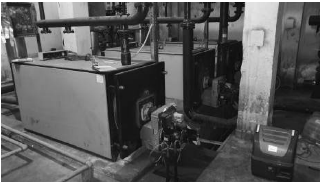
Πίνακας 2.4.9: Καταγραφή Λεβήτων Θερμού Νερού
