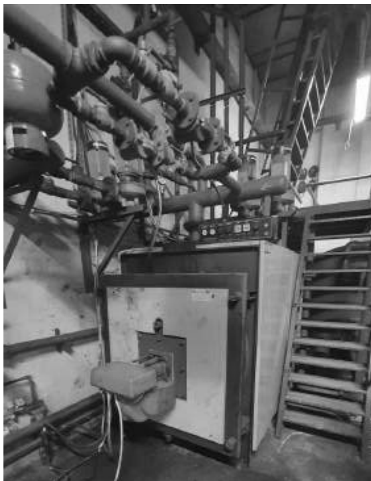
Πίνακας 2.4.5: Καταγραφή Λεβήτων Θερμού Νερού
