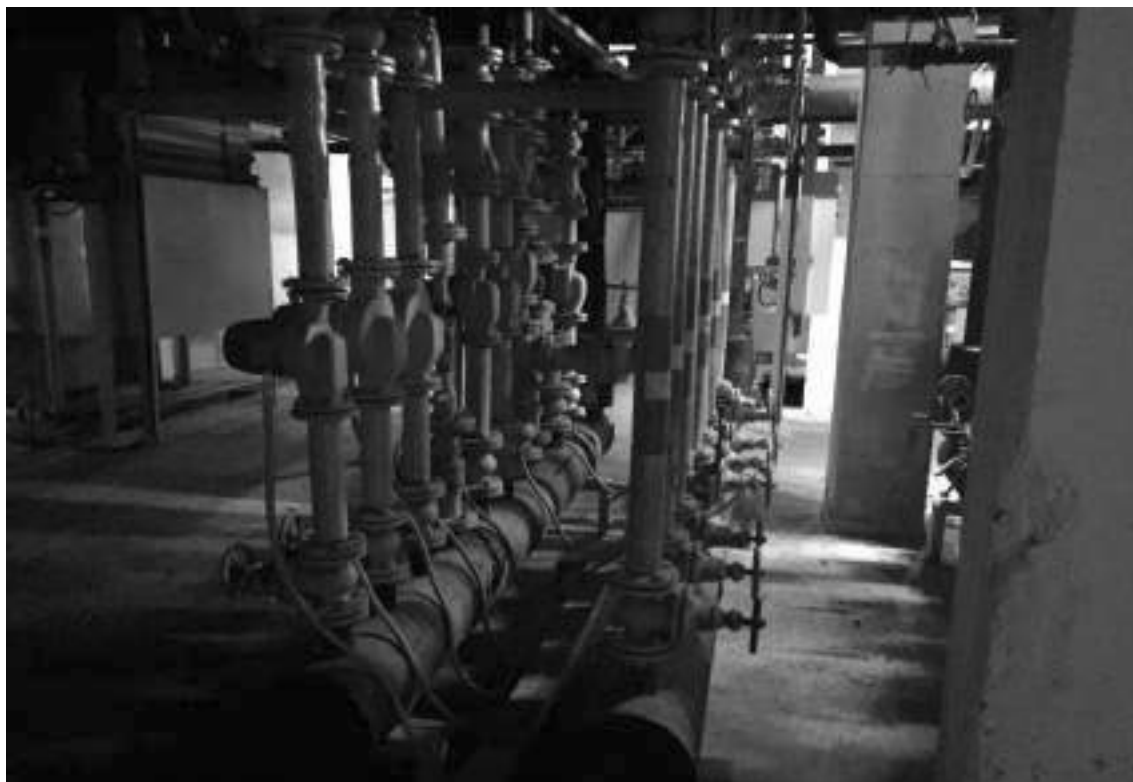
Εικόνα 2.4.15: Επιμέρους Διανομείς Θερμού Νερού (No 3)
