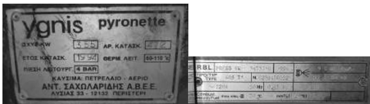
Εικόνες 2.4.6: Λέβητες Θερμού Νερού κτιρίου
