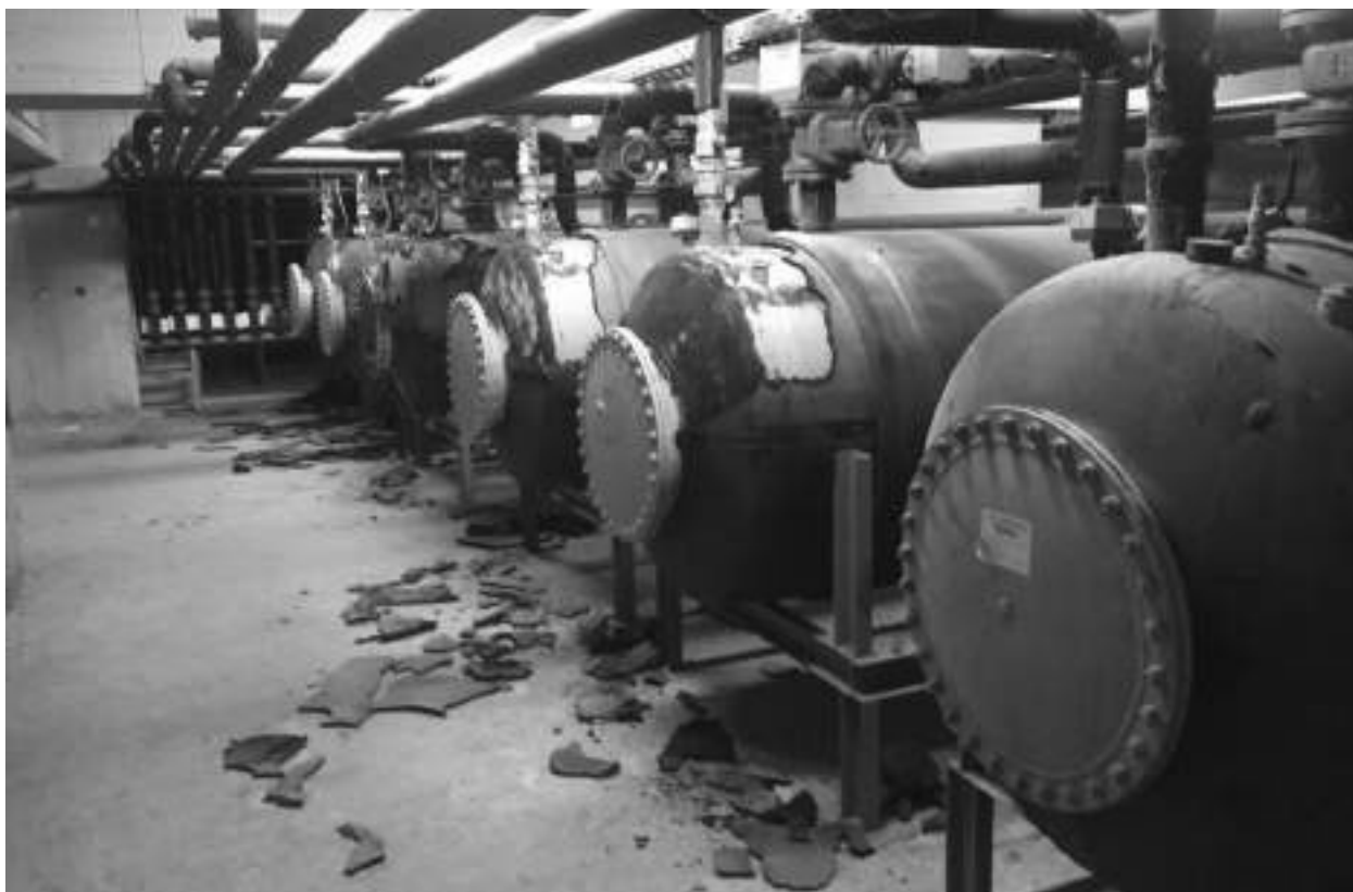
Εικόνα 2.4.3: Θερμαντήρες (Boiler) του κτιρίου
