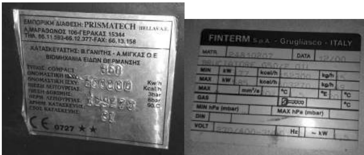
Εικόνες 2.4.11: Λέβητες Θερμού Νερού κτιρίου
