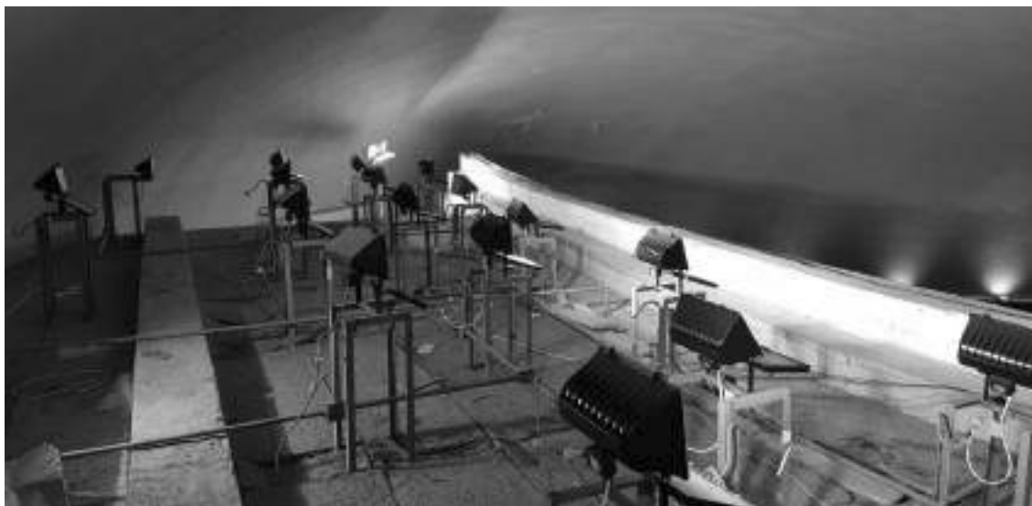
Εικόνα 4.1.3: Προβολείς Φωτισμού θόλου στο Αμφιθέατρο του Διοικητηρίου
