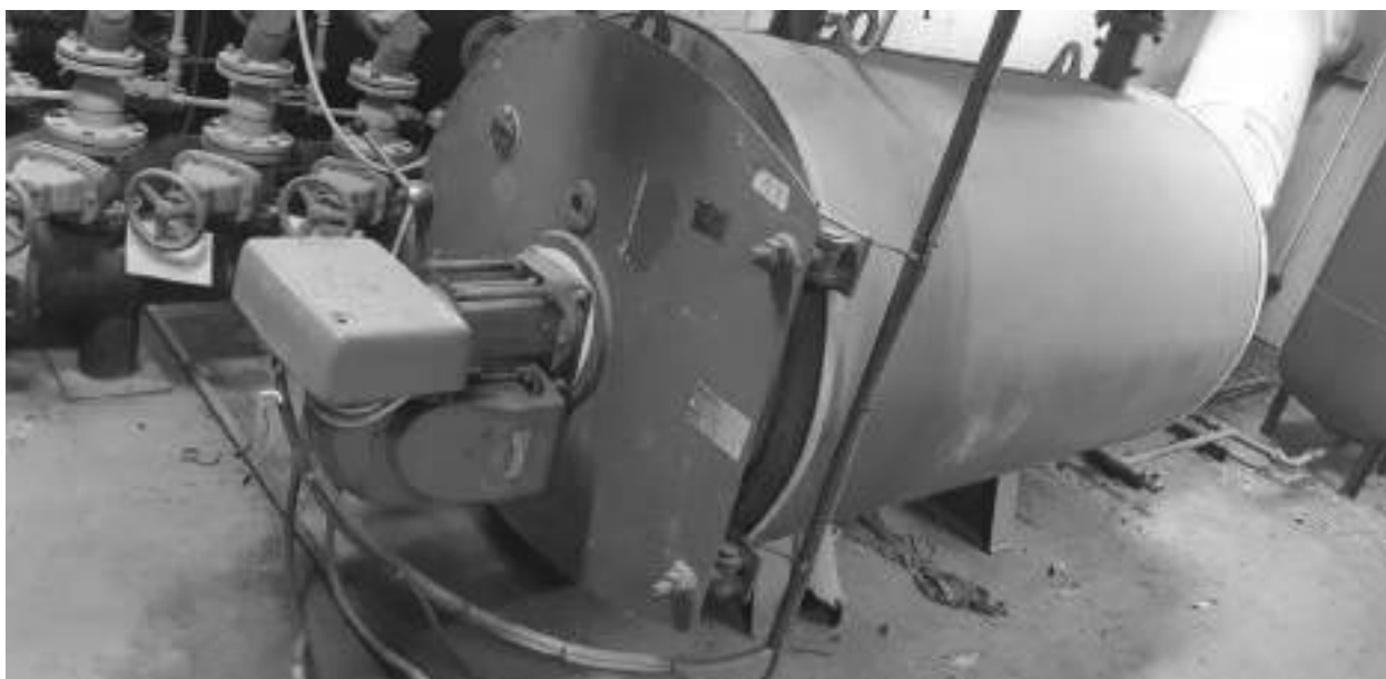
Πίνακας 2.4.2: Καταγραφή Λεβήτων Θερμού Νερού
